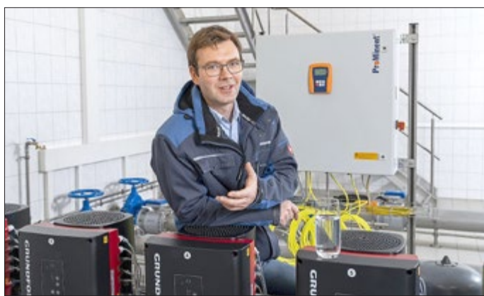
Christian Senge, Projektingenieur der EW Wasser GmbH, erklärt die Funktionsweise des neuen Hochbehälters „Kötergrund“.
